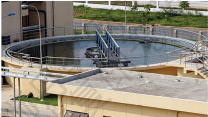
越南厂区污水处理系统
